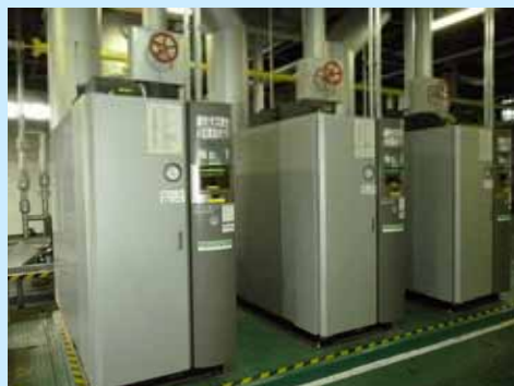
貫流ボイラ外観
